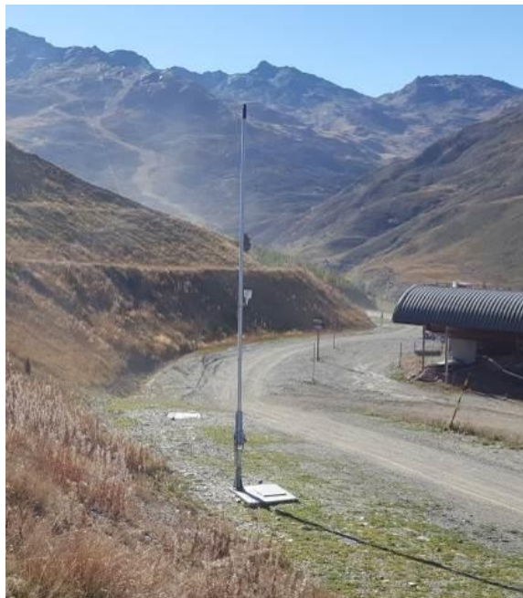
Photographie exemple d'un regard neige surmonté d'un enneigeur perche, comme prévu sur la zone de projet
